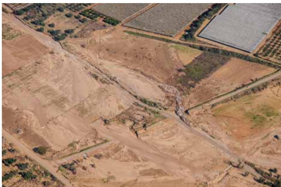
Foto 5 - Agro di Ginosa – Strada Comunale Casone Dogana (Torrente Vallone della Rita). Foto di un altro tratto stradale interrotto in cui il terrapieno è crollato in due punti. Uno lungo il letto ordinario del corso d'acqua, l'altro in prossimità di un secondo flusso intenso di acqua sviluppatosi nel letto di piena (Foto G. D'Onofrio).
