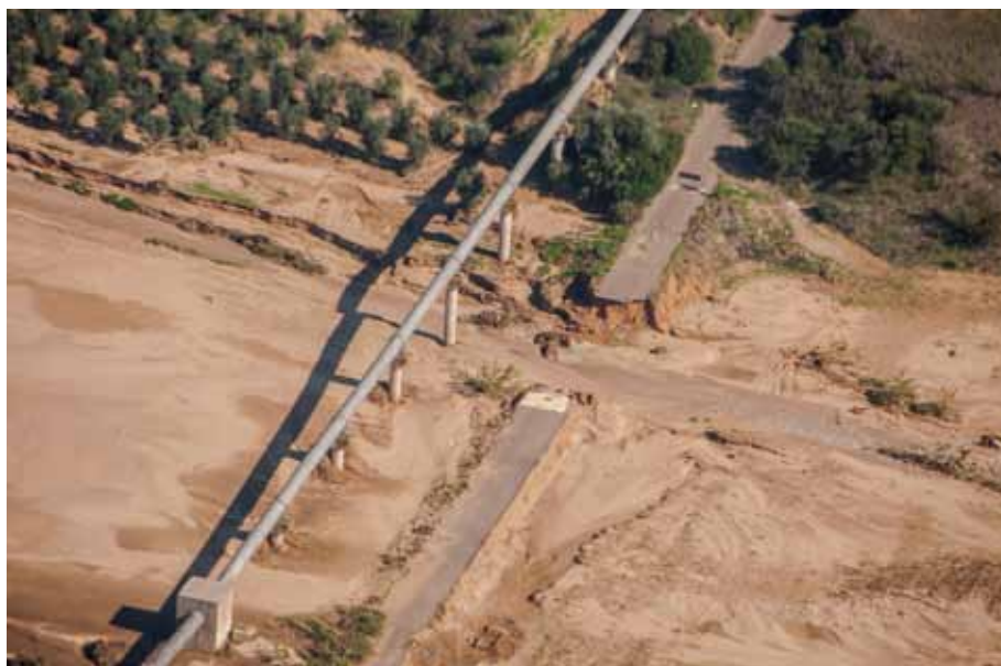
Foto 4 - Agro di Ginosa – Strada Comunale Cipolluzzo (Torrente Vallone della Rita). Nella foto si nota il crollo del terrapieno stradale in prossimità del letto ordinario. E' evidente che il crollo sia stato causato dall'elevata altezza e velocità della massa d'acqua dell'onda di piena non adeguata alla luce delle condotte di deflusso del manufatto (Foto G. D'Onofrio).
